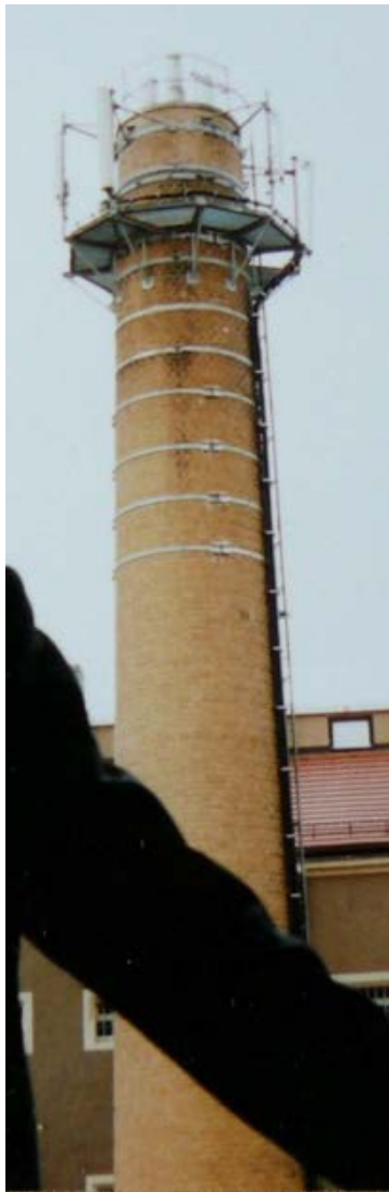
Mobilfunksendeanlage an dem Kamin des Gerichtsgebüdes
