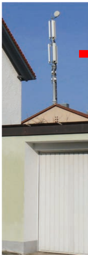
Mobilfunk- sendeanlage Nr. 671234
