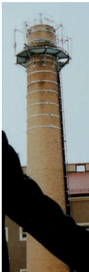
Mobilfunksendeanlage an dem Kamin des Gerichtsgebäudes
