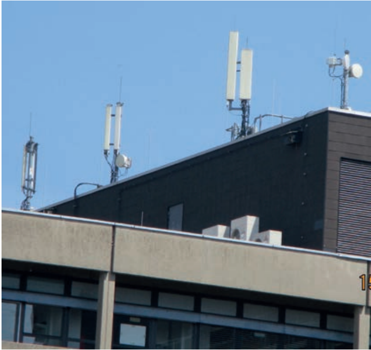
Mobilfunksendeanlage auf den Chemischen Instituten
